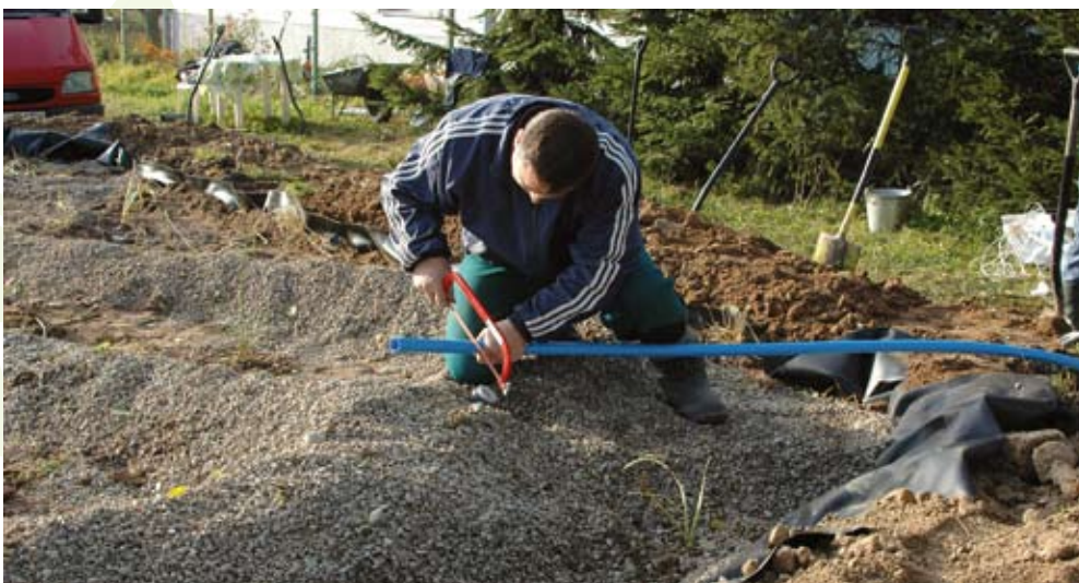
Zdjęcie 37. Połączenie osadnika z drenażem rozsączającym
