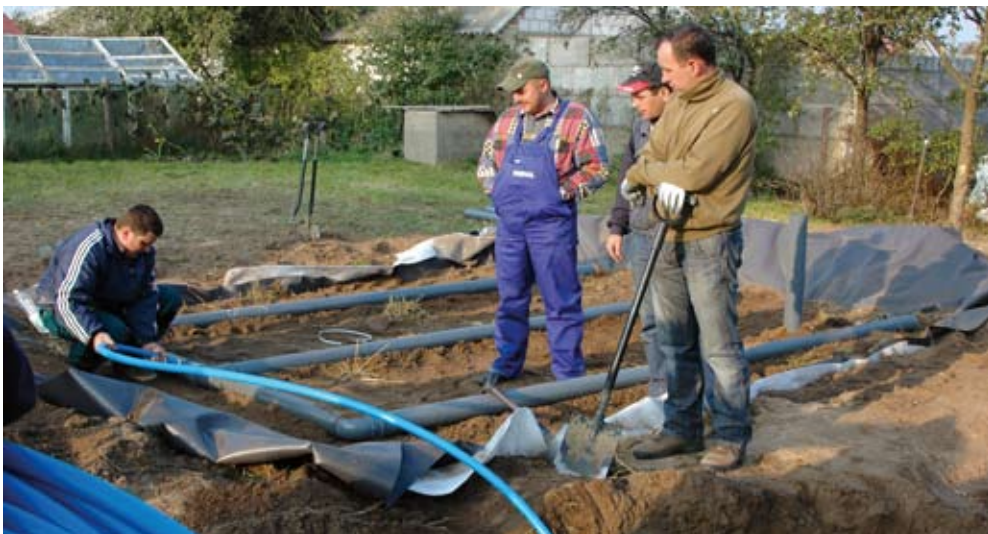
Zdjęcie 36. Połączenie osadnika z drenażem rozsączającym
